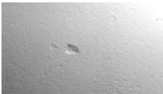
خوردگی pitting مجزا
